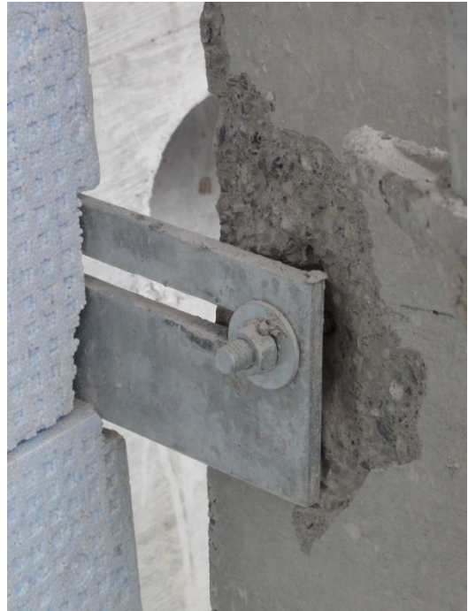
Bild 30: Abplatzungen am Lichtschacht durch unvorsichtiges bohren der Löcher für die Befestigungswinkel
