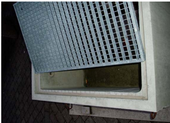
Bild 38: Gitterrost auf Falz (S. Position 13)
